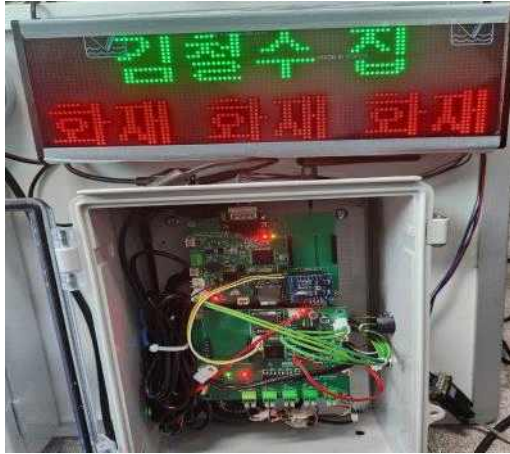
그림 4. 화재 초기 알림시스템 작동 Figure 4. Operation of Fire early notification system
