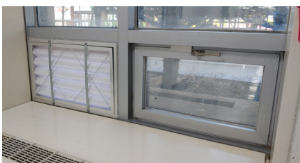
(b) 병실 앞 복도 창문 개방 및 필터 설치 현황
