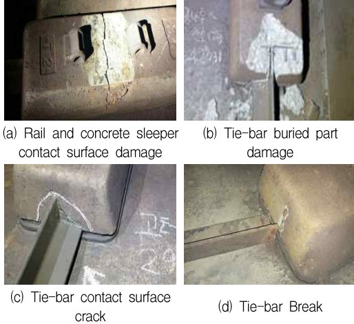
그림 2. 콘크리트침목 손상 전경 Figure 2. Photographs of damaged concrete sleepers
