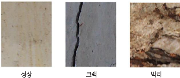
그림 1. 콘크리트 상태의 분류 예시: 정상, 크랙, 박리
