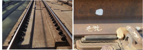
그림 8. 직결식 레일체결장치 손상전경 Figure 8. Photographs of direct fixation concrete track
