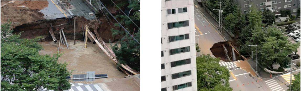
〈그림 2〉 도심지 터널에서의 지반침하(싱크홀)사고
