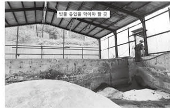
가축분뇨 저장 및 퇴비시설
