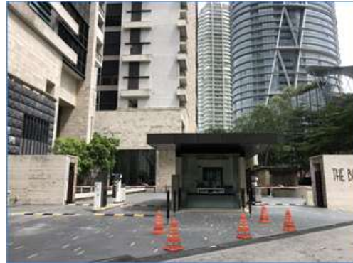
<그림 9> 말레이시아 쿠알라룸푸르 빌딩 출입구에 설치한 차량 번호판 인식 시스템
