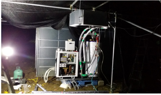
그림 1. 설치된 시스템 Fig. 1. Installed Systems
