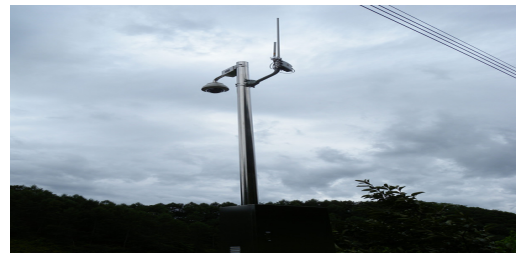
그림 8. 안테나 폴 Fig. 8. Antenna pole
