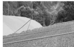
축사 지붕 위 스프링클러
