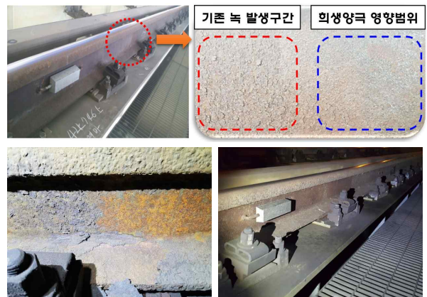
(a) without Al-anode (b) with Al-anode 그림 4. 희생양극 설치유무에 따른 부식상태 비교 Figure 4. Comparisons corrosion state by Al-anode installation
