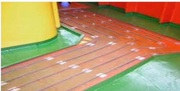
그림 9 Status of installation of heating cables for ships
