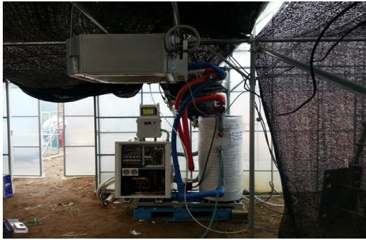
그림 6. 실외기와 실내기 Fig. 6. Outdoor and indoor Device
