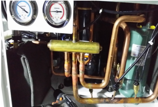
그림 3. 연결부 및 게이지 Fig. 3. Connections and Gauges
