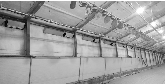
▲ 터널식 환기 기법을 위한 환풍기와 터널
