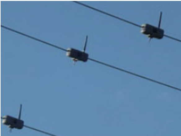
그림 6. 미국 캘리포니아에 설치된 무선 송전선 감지 센서 (출처: https://en.wikipedia.org/wiki/Wireless_powerline_sensor#/media/File:WirelessPowerlineSensors3.jpg )
