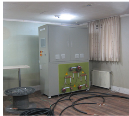
그림 3. 도체온도와 표면온도의 변환장치 설치 상태 Fig. 3. Installation status of device for converting conductor temperature into surface temperature
