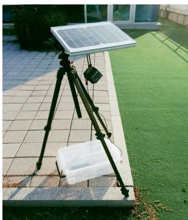
그림 7. 설치된 에너지 하비스팅 시스템 Fig. 7. Installed energy harvesting system.
