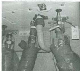
가스보일러 배관 오연결 (동일유형)
