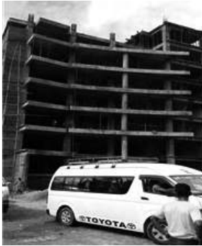
그림 15. 규정을 위반한 신축중인 6층 이상의 건축물
