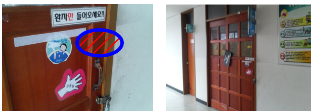
Figure 3. No Safety Device on Door(안전장치 없는 출입문)
