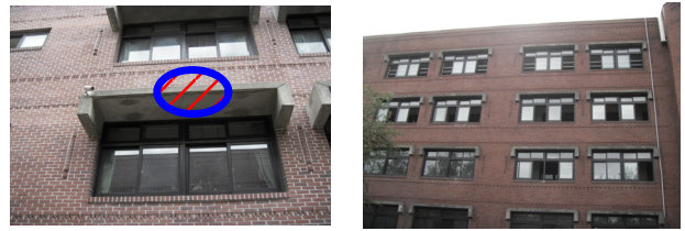
Figure 2. No Safety Device on Veranda(안전장치 없는 베란다)
