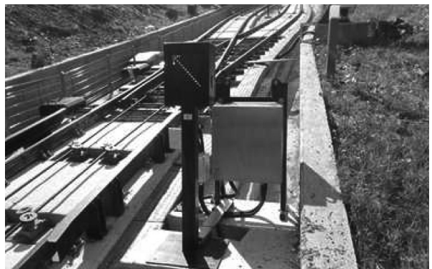
〈그림 10〉 분기기 제어판넬 설치
