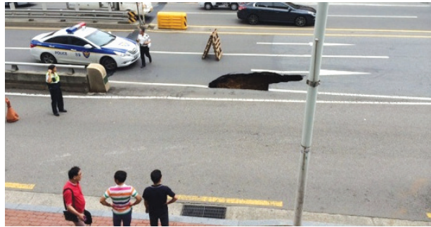
a 석촌지하차도 도로 함몰 (2014. 08. 05)
