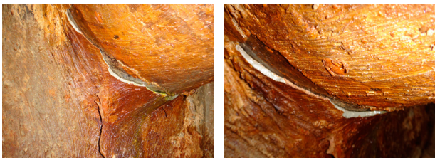
Fig. 3 밸브 유입측 배관 차수 시멘트 파손
