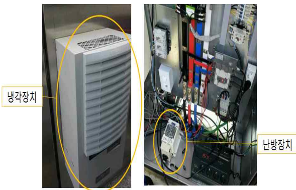
그림 4. 수배전반 내부 냉각 및 난방 장치 Fig. 4. Cooling Device and Heating Device of Power Production Part
