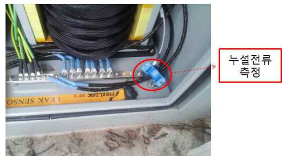
그림 6. 전력변환부 누설전류 측정 Fig. 6. Leakage Current Measurement of Power Conversion Part
