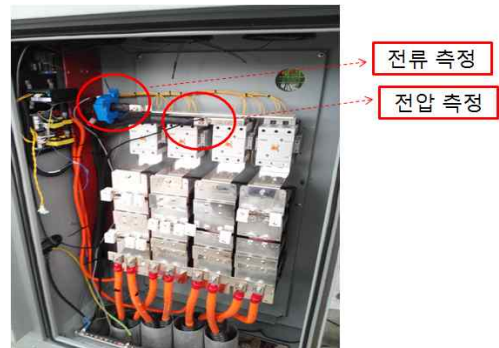
그림 5. 전력변환부 전압, 전류 측정 Fig. 5. Voltage, Current Measurement of Power Conversion Part
