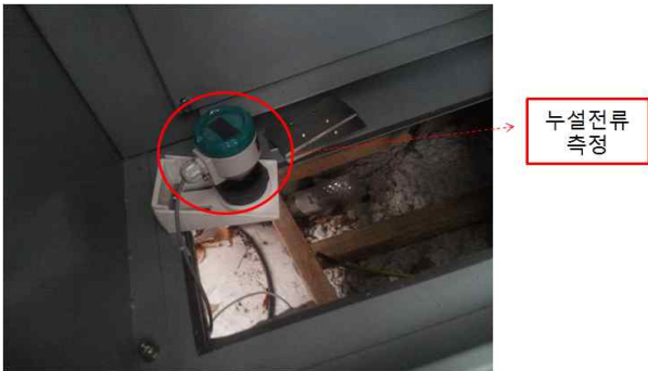
그림 7. 전력변환부 수위센서 설치 Fig. 7. Water Level Sensor Installation of Power Conversion Part
