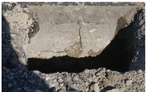
그림 8. 시험도로 CRCP 수평균열
