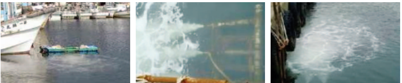
마이크로버블 장치 설치 운영모습
