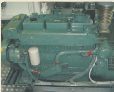
▲ 주발전기 Main Generator
