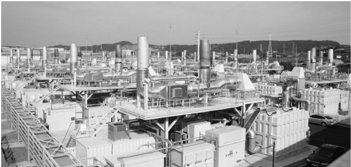
[그림 1] 경기그린에너지 연료전지발전소 전경
