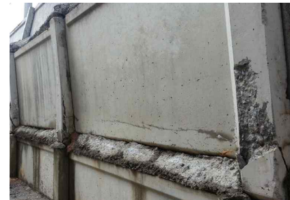
Fig 4. Damaged situations of the wall structure (지지기둥의 철근노출, 전도위험, 표피탈락, 접합부 분리, 수평균열 발생 등)
