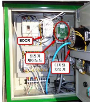
그림 4. 집진기 제어패널 내부 구성 Fig. 4. The inner parts of a control panel.
