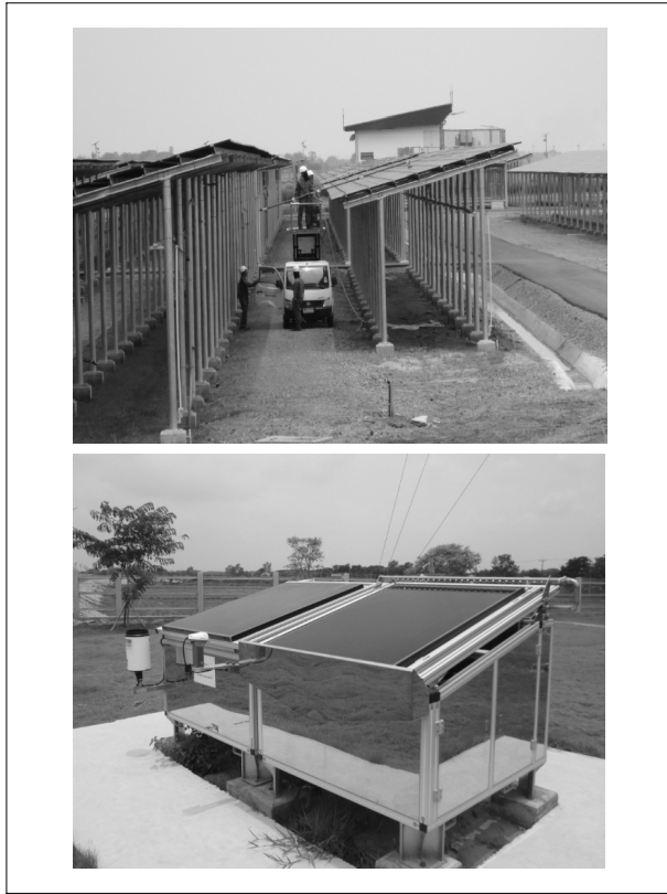
Fig. 2 태양광 모듈 설치상태 및 수세정 모습(상) 및 Dust Detection System(하)
