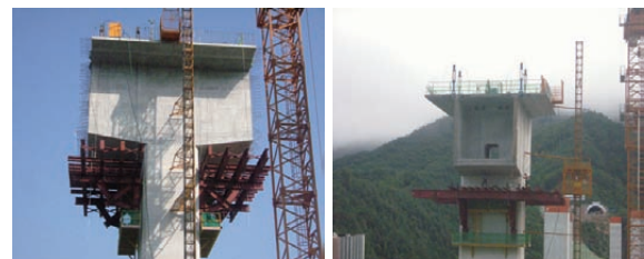
사진 2. 방태천1교 주두부가시설 현황
