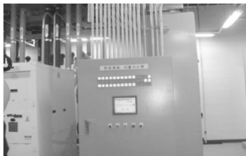
(d) 자동제어 설치
