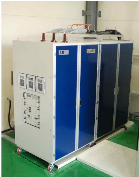
그림 4. 한전 고창 실증시험용 복합형 초전도 한류기(22.9kV/630A).
