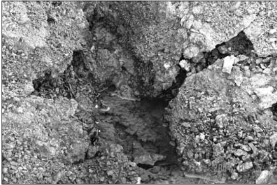
그림 5. 산성배수에 의한 콘크리트 부식
