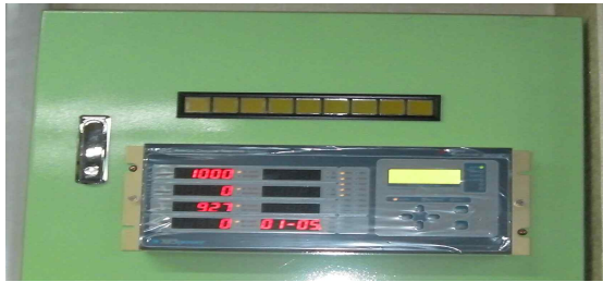
그림 2. 최대전력저감장치 설치 사진(앞) Fig. 2. Photo installed peak power reduction device(front)
