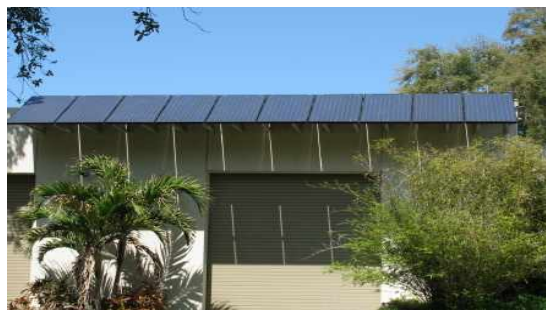
그림 1. USF 캠퍼스에 설치된 PV 패널 Fig. 1. PV panels installed in USF campus
