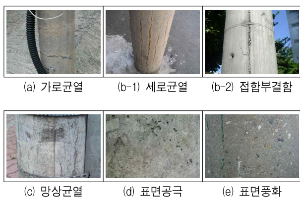
그림 1. 콘크리트전주의 외관불량 유형 Fig. 1. Poor appearance types of concrete pole
