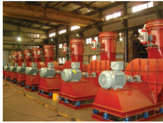
원심형 송풍기(고온형 송풍기)
