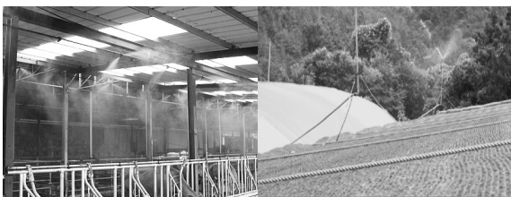
〈축사 내부 스프링쿨러〉
