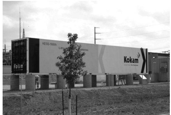
[그림 13] 미국 미주리 주에 설치된 1MW/ 1MWh ESS 설치 전경(자료 : 코캄)
