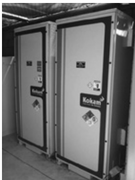
[그림 14]미국 샌디에이고 태양광 연계 EV 충전소 ESS 설치 전경(자료: 코캄)
