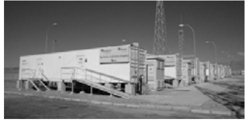
[그림 10] AES 12MW/3MWh급 ESS 시설 전경 (자료 : AES)
