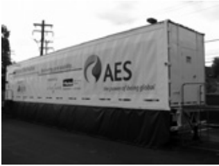
[그림 8] "Project Barbados" 2MW/ 500kWh ESS 시설 전경 (자료 : AES)
