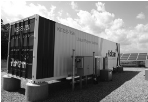
[그림 12] Marshall Project 1MW/750kWh ESS 설치 전경 (자료 : 코캄)
