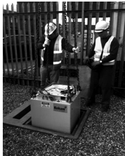
[그림 11] 25kW/50kWh CES 설치 전경 (자료 : 코캠)
