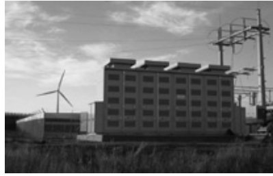
[그림 3] 루체른에 설치된 NaS ESS (자료 : Sandia Report, 2013)
