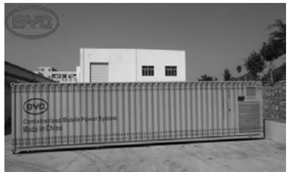
[그림 15] Alameda 감옥에 설치된 S&C/BYD의 2MW/ 4MWh ESS(자료 : BYD)
