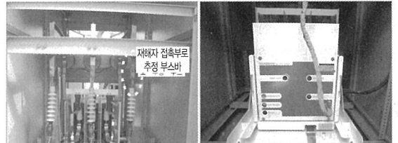
【그림 3】 VCB 1차측 단자(패널 후면) 【그림 4】 사고발생 당시 아크(Arc) 흔적
