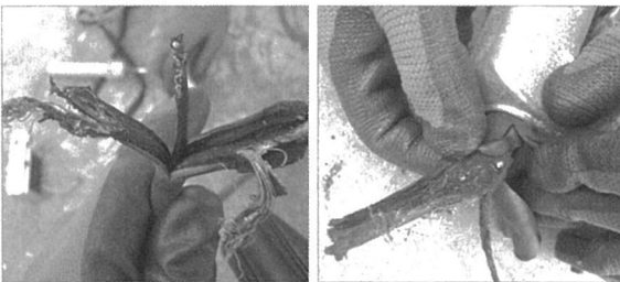
전원 측 리드선 심선의 용융흔적 해머 측
