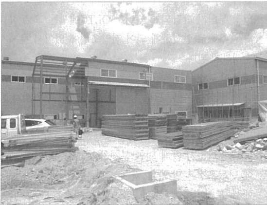
【그림 1】 사고현장 전경
