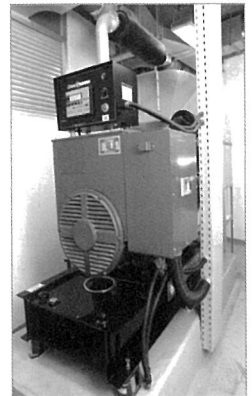
[사진 1] 비상용 발전기(118kW)
