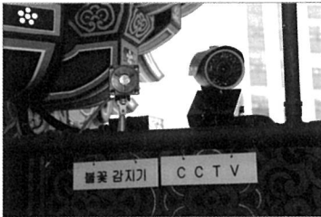
[사진 3] 문루 불꽃감지기 및 CCTV
