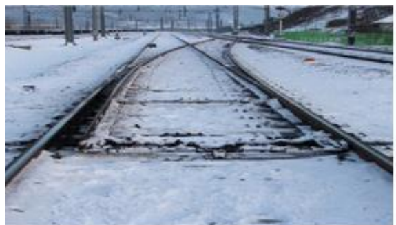
그림 14. 실제 설치된 융설장치 Fig. 14. INSTALLED HEATING CONTROL SYSTEM
