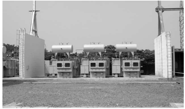
[그림 6] 50MVA STATCOM 주변압기
