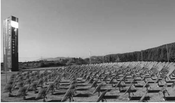
[그림 5] 국내 최초 대구 200kW 중앙흡수기형 태양열 발전소
