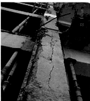
기둥 균열, 철근부식 현황
