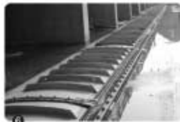
설치 후 전도 상태
