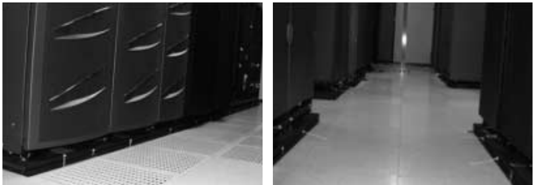
데이터 센터 설치 전경
