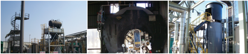
〈그림 2〉 보일러시스템 설치 전경
